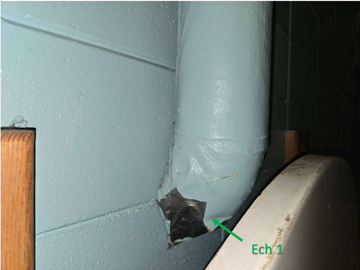
Photo 1 : Ech 1. Tuyau coude 22'', Gym, matériau qui n'est pas considéré comme MCA.
